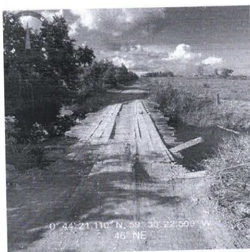
Foto 27: Ponte de madeira na vicinal 012 com 15 m de comprimento, com altura de 2,00 m, com 8,49 km de distância até o entrocamento da vicinal 012 com a BR-210, apresentam ausência de peças fundamentais à segurança de seus usuários como guarda rodas, a ponte apresenta recalque em sua cabeceira e tabuleiros soltos.
