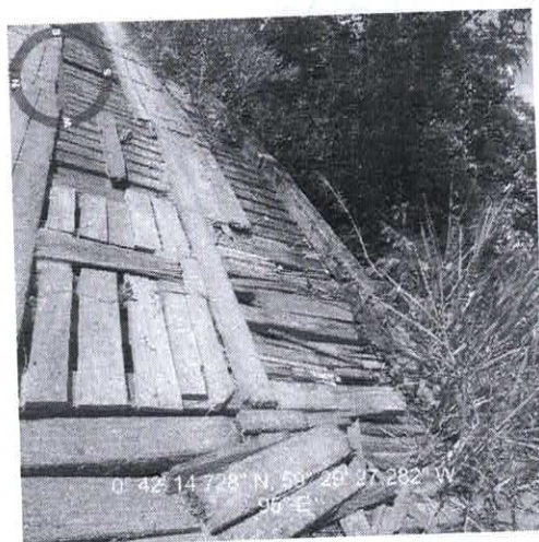
Foto 18: Ponte de madeira na vicinal 014 com 15 m de comprimento, com altura de 4,0 m, com 10,2 km de distância até o entrocamento da vicinal 014 (CAB-367) com a BR-210, observa-se o péssimo estado da ponte com diversos reparos improvisados, tabuleiros e deslizantes quebrados, bem como madeirada mesoestrutura em estado de decomposição.
