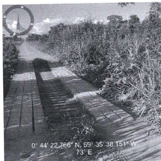
Foto 29: Ponte de madeira na vicinal 08 com 10 m de comprimento, com altura de 2,00 m, com 7,2 km de distância até o entrocamento da vicinal 08 com a BR-210, ponte apresenta recalque no centro de sua estrutura, colocando em risco seus usuários.
