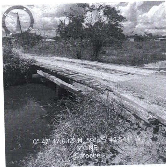
Foto 11: Ponte de madeira na vicinal 014 com 20 m de comprimento, com altura de 4 m, com 0,1 km de distância até o entrocamento da vicinal 014 (CAB-367) com a BR-210, observa-se as vigas longarinas da ponte desprendendo-se da estrutura, gerando grande risco a seus usuários.
