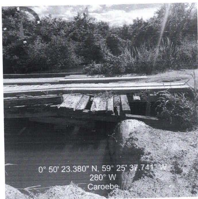
Foto 26: Ponte de madeira na vicinal 013 com 15 m de comprimento, com altura de 2 m, com 4,84 km de distância até o entrocamento da vicinal 013 com a BR-210, apresentas peças quebradas e estrutura totalmente comprometida apresentando ruptura eminente.
