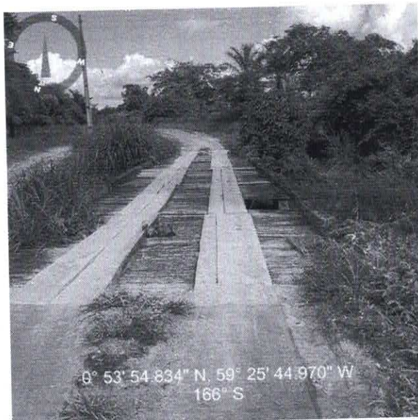
Foto 21: Ponte de madeira na vicinal 013 com 30 m de comprimento, com altura de 4 m, com 11,24 km de distância até o entrocamento da vicinal 013 com a BR-210, encontra-se com suas peças soltas e estrutura totalmente compormetida, buracos existente pela quebra de tabuleiros longarinas soltas, despredendo-se da estrutura da ponte gerando severo perigo a seus usuários.
