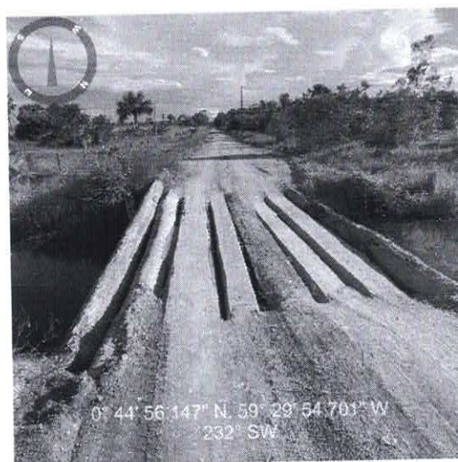
Foto 28: Ponte de madeira na vicinal 012 com 10 m de comprimento, com altura de 2,00 m, com 10,97 km de distância até o entrocamento da vicinal 012 com a BR-210, ponte improvisada, completamente fora dos padrões.
