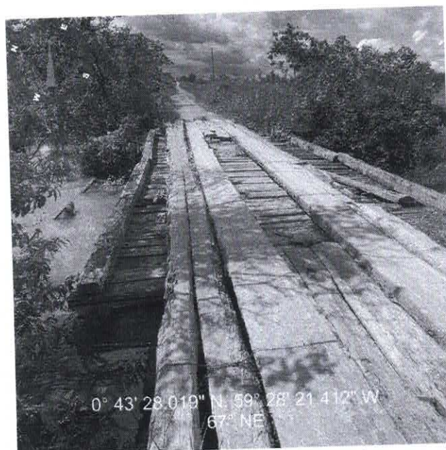
Foto 15: Ponte de madeira na vicinal 014 com 20 m de comprimento, com altura de 4,5 m, com 9,0 km de distância até o entrocamento da vicinal 014 (CAB-367) com a BR-210, observa-se o péssimo estado da ponte com diversos reparos improvisados, com a madeira em estado de decomposição.
