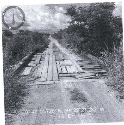
Foto 18: Ponte de madeira na vicinal 014 com 15 m de comprimento, com altura de 4,0 m, com 10,2 km de distância até o entrocamento da vicinal 014 (CAB-367) com a BR-210, observa-se o péssimo estado da ponte com diversos reparos improvisados, tabuleiros e deslizantes quebrados.
