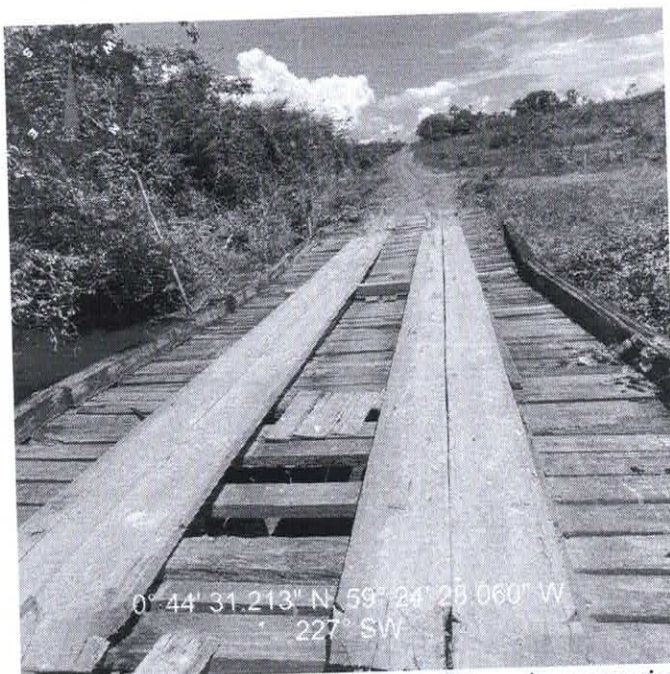
Foto 07: Ponte de madeira na vicinal 016 com 25 m de comprimento, com altura de 3,5 m, com 5,8 km de distância até o entrocamento da vicinal 016 (CAB-369) com a BR-210, observa-se o desgaste nas peças, devido ao recalque sofrido a ponte encontr-se em risco de colápsio.
